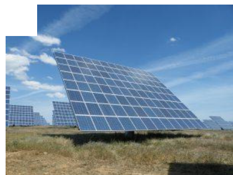
Central Fotovoltaica de Amareleja
